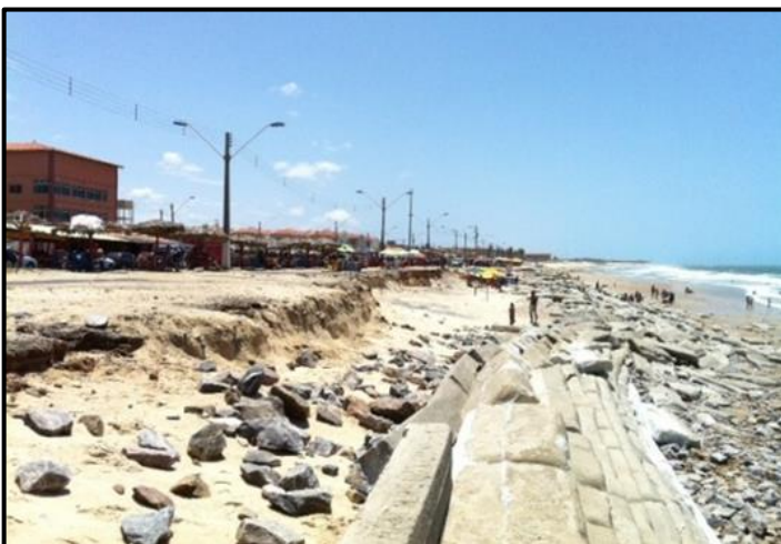
Figura 2: Bag wall parcialmente destruído na Praia do Icarai. Fonte: Oliveira, 2014.
